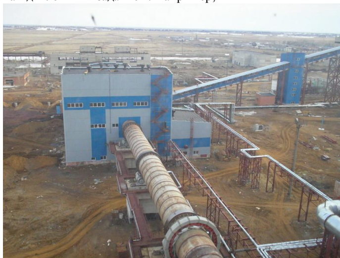
Рис. Обжиговая печь. Вид сверху. Концентрат непрерывно загружается в герметизированную печь под точкой съемки и при вращении печи перемещается под уклон вперед вдоль нее. В дальнейшем
